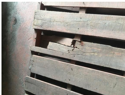
Gambar 1. 1 Pallet yang roboh akibat terinjak oleh pekerja yang berjalan diatasnya
