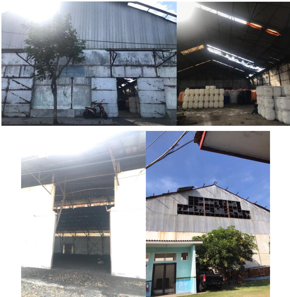
Gambar 3. 6 Gudang Tidak Layak Pakai
