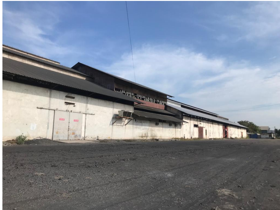
Gambar 3. 7 Kerusakan Jalan Pelabuhan
