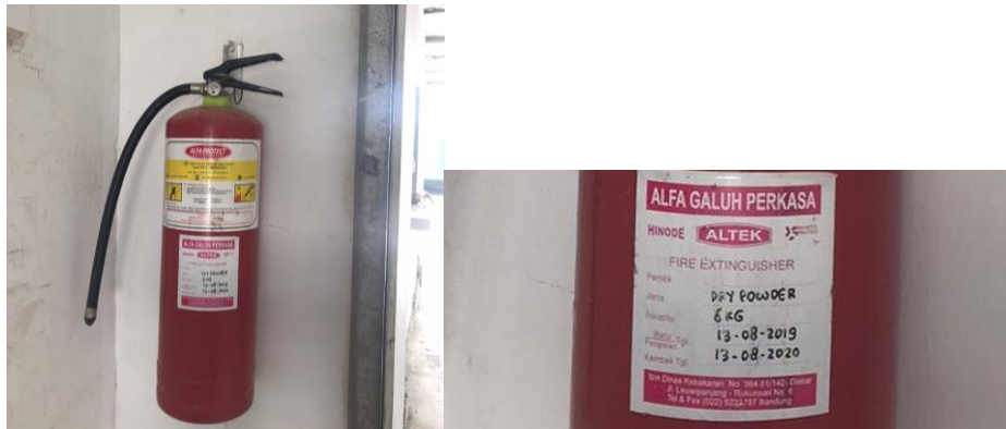
Gambar 3. 14 APAR di Unit Angkutan Barang
