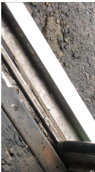
Gambar 3. 3 Rel pintu berdebu
